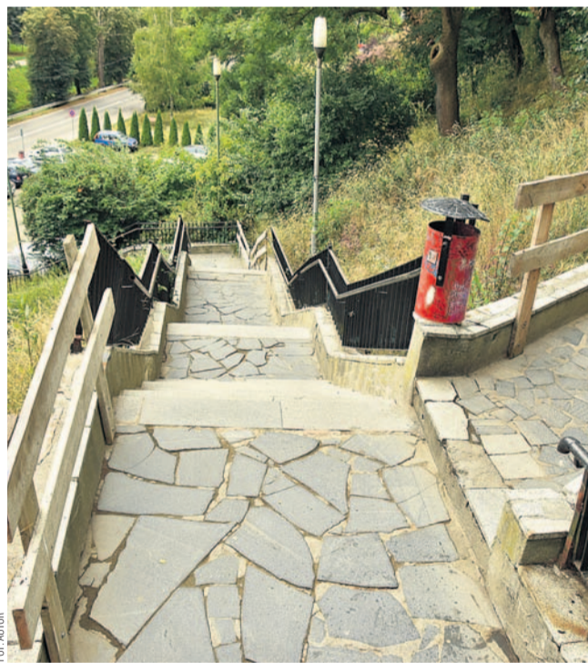
Obecny stan na schodach
